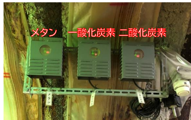
地下の環境を監視するセンサー
